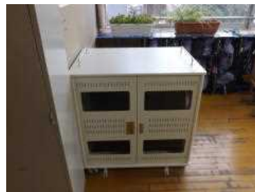
タブレットが保管されている電源キャビネット
